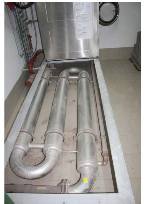
Rohr-in-Rohr Wärmetauscher zur Rückgewinnung von Energie aus dem Schmutzwasser der Schafwoll-Waschmaschine
